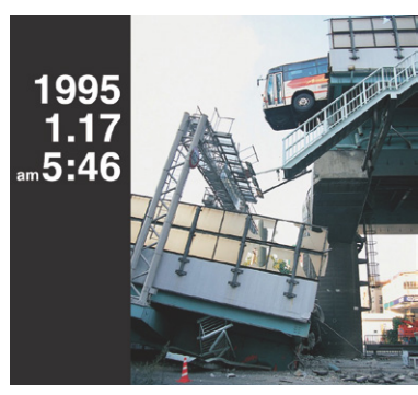
写真1 兵庫県南部地震による阪神高速道路の被害
