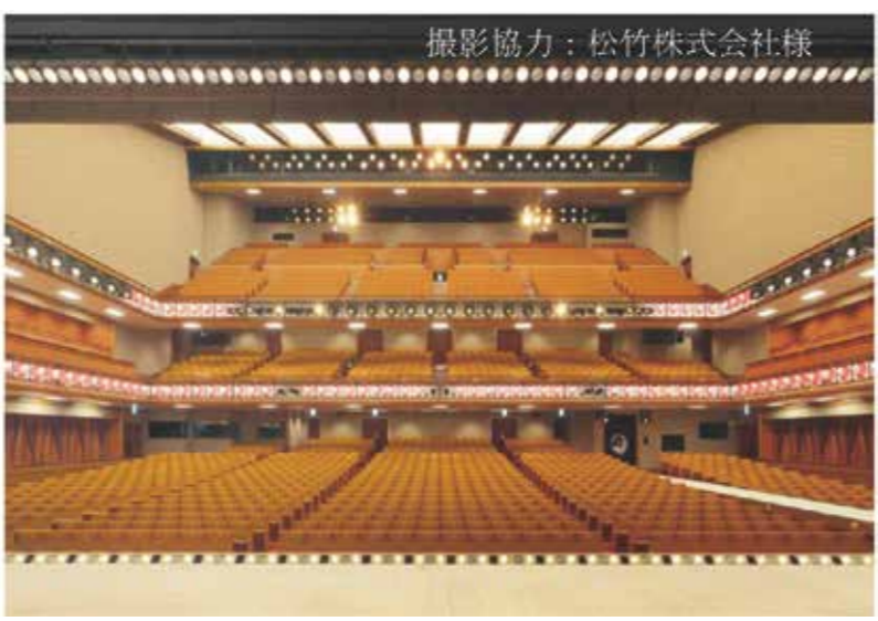
図1 歌舞伎座の照明設備
